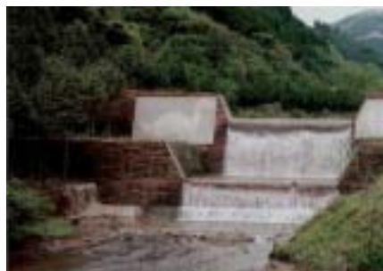
図1 和歌山県花園村の砂防工事に用いられている環境配慮型木製型枠
