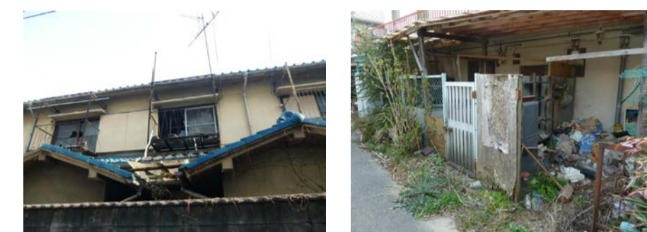
放置され、荒れた空き家（岸和田市内）
