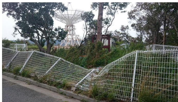
2018年9月4日の台風21号で被害を被った設置予定場所
