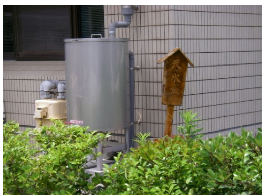
雨水タンク (西3号館)
